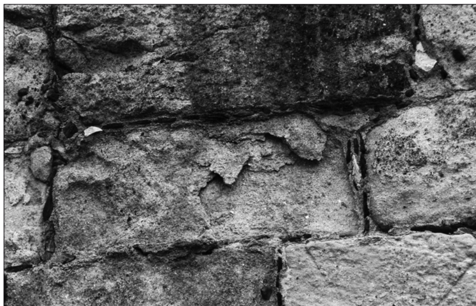
FIG. 24.—Alteración de la capa superficial en algunos sillares del puente Mayor de Salamanca.
