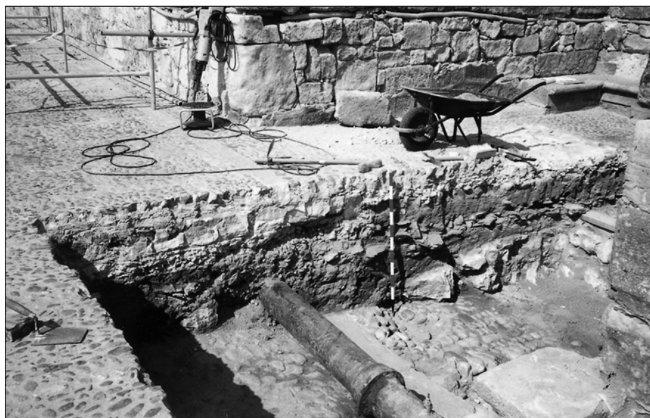
FIG. 21.—Tubería instalada en época reciente en el relleno del puente Mayor de Salamanca.
