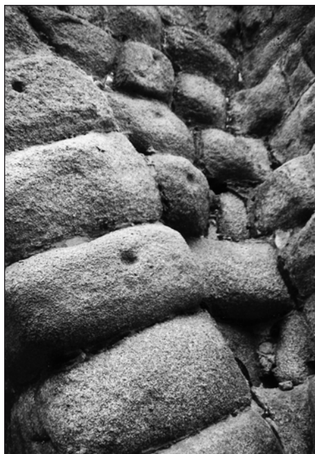
FIG. 20.—Utilización reciente de pequeños cantos de pizarra en las juntas rebundidas por erosión de la sillería romana del puente Mayor de Salamanca
