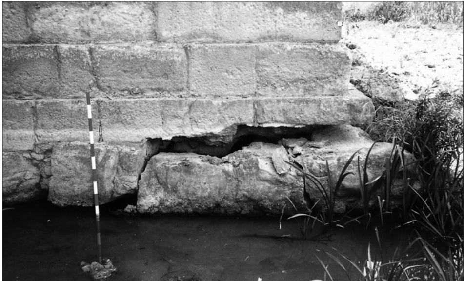
FIG. 19.–Efecto del lavado del terreno en una esquina de una pila del puente Mayor de Salamanca.
