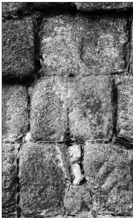
Fig. 22.–Ejemplo de grietas antiguas en sillares del puente Mayor de Salamanca.
