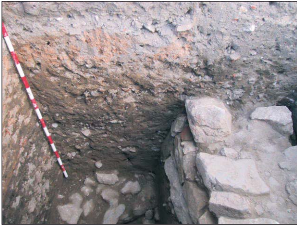
FIGURA 3.—Sondeo 4. En la sección se aprecia el nivel amarillento de derrumbe de adobes que apoyaría sobre el zócalo de mampostería que se ve a la izquierda de la fotografía.
